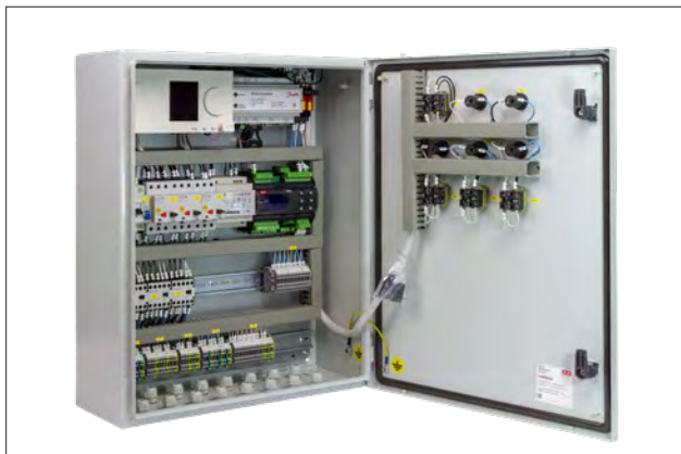
Рис. 48. Шкаф автоматизации «Данфосс»
