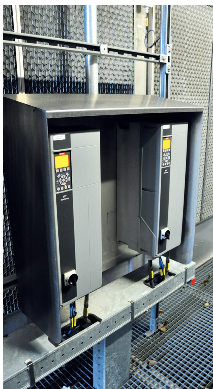
Buitenopstelling met 2 VLT HVAC drives FC 102 in IP55 met ingebouwde werkschakelaar voor de regeling van koeltorens.
