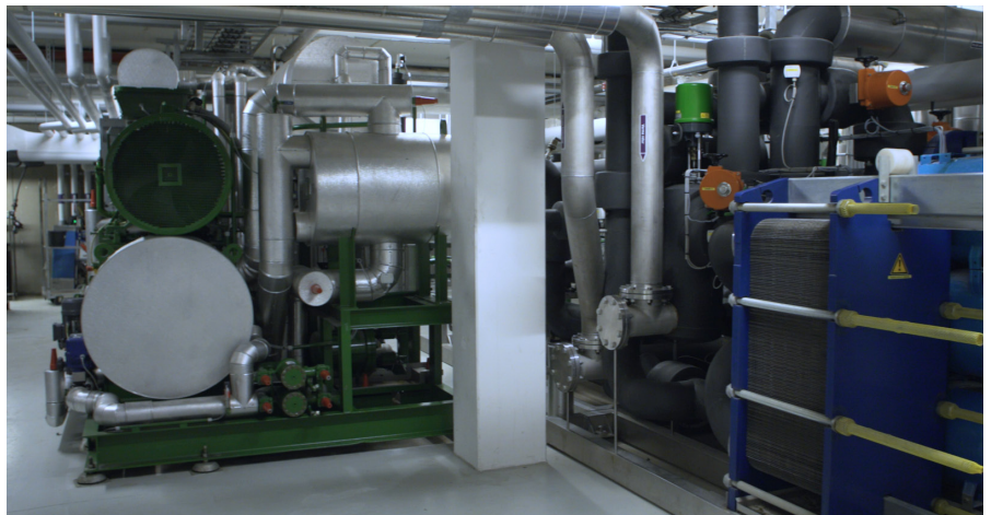
L'eau refroidie provenant de l'échangeur de chaleur circule dans le bâtiment pour refroidir les chambres à la température souhaitée. Aucune réfrigération active n'est requise.
