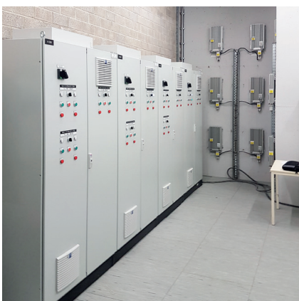
L'un des deux locaux techniques avec des résistances de freinage sur le mur du fond.
