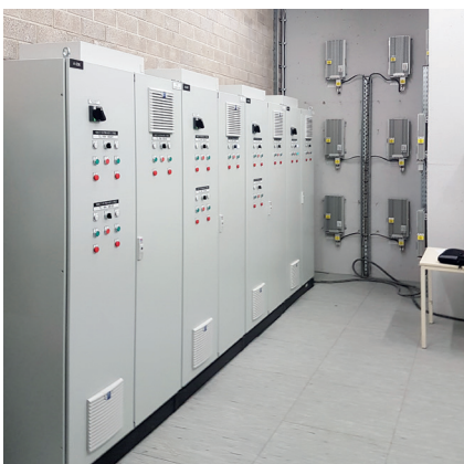
Een van de twee technische ruimtes met remweerstanden aan de achterwand.
