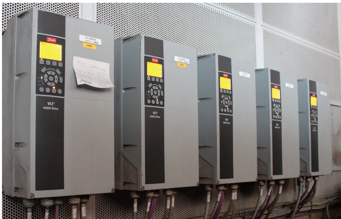
生物气体发电：VLT® AQUA 变频器控制冷却风扇，提高工厂效率。
