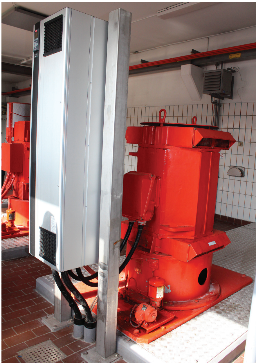
排水泵站：具有 IP54 箱体的 160KW VLT® 控制着重量为 1.25 吨的泵
