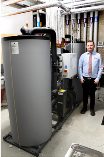
Morten ja lämmöntalteenottoyksikkö.
