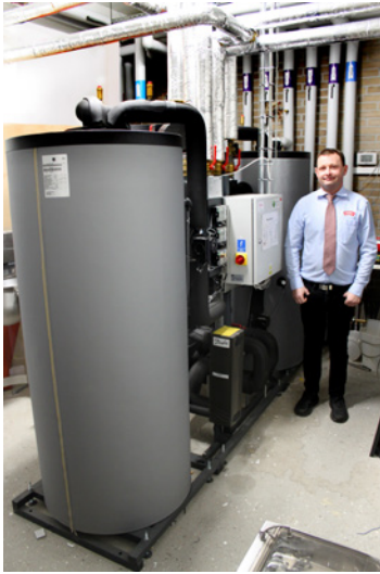
Morten ved Varmegjenvinningsenheten (HRU).
