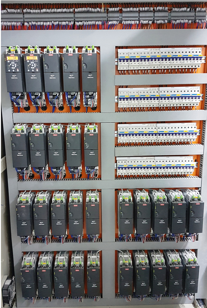
Der VLT® Midi Drive FC 280 und der VLT® AutomationDrive FC 302 mit Integrated Motion Controller Seite an Seite installiert.
