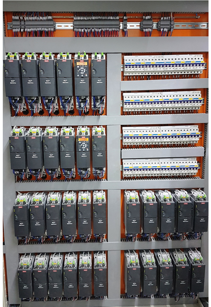
Insgesamt kann sich die Gebäckfabrik auf 100 installierte VLT® Midi Drives verlassen, die zuverlässig so unterschiedliche Geräte wie Lüfter, Transporteure und Mixer steuern.
