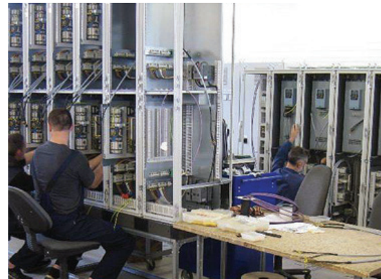
安装在开关柜中的VACON®有源前端/共直流母线模块。Vacon (伟肯) 的有源前端技术符合最严格的谐波失真要求, 经过挪威船级社 (Det Norske Veritas) 认证。如果需要, 它还可将绞车制动产生的能量回馈到船舶的电网中。
