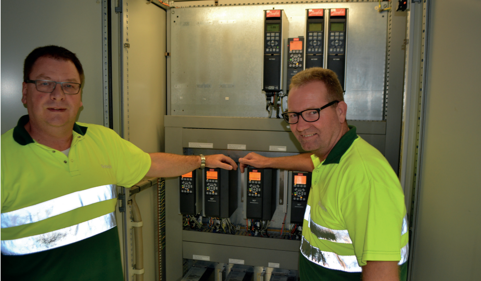
Besturingskast met Danfoss FC 302 frequentieregelaars en Jan Brouwers, detail-engineer en Berry de Vaan, detail-engineer software, beiden bij Heineken 's-Hertogenbosch
