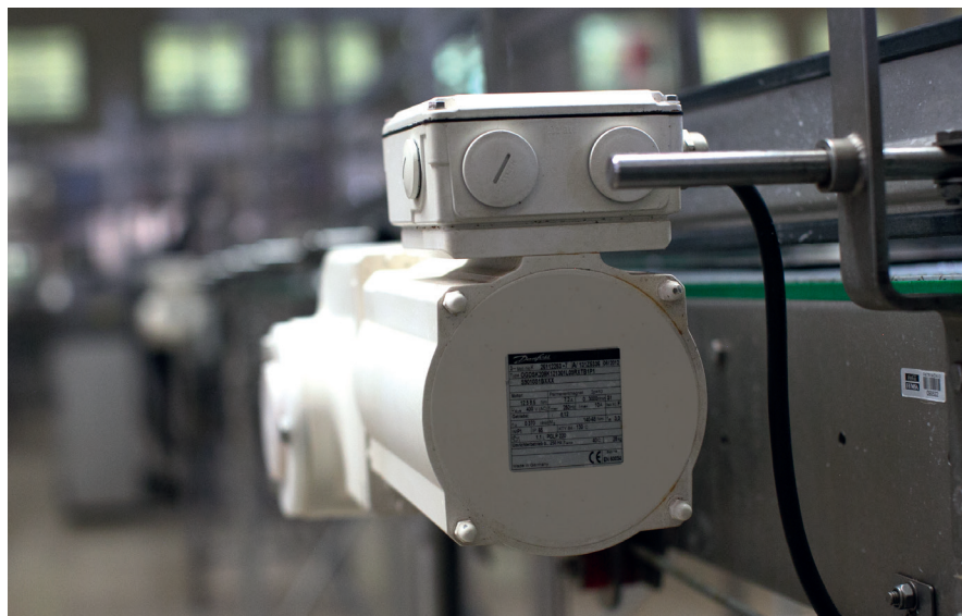
Przetwornice VLT® sterują prędkością przenośników linii butelkowania. Są zamontowane zarówno decentralnie...
