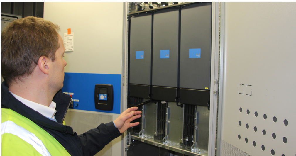
Sverre Knapstad, Frekvensomformer.no demonstrerer VACON® NXP modulene installert inne i containeren.
