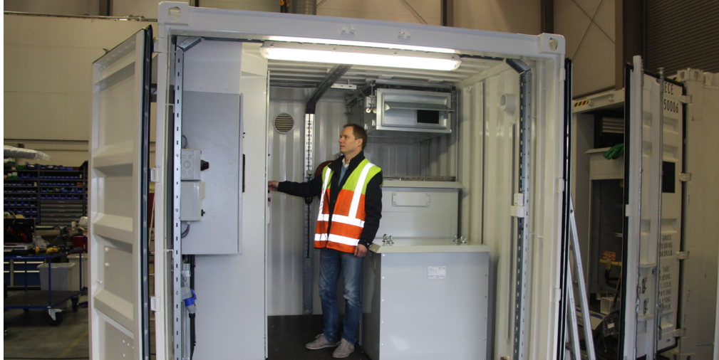
Sverre Knapstad med et nytt 450 kVA kompakt landstrømsanlegg i en 10-fots container. VACON® omformere tilpasses med kontroller og indikatorer etter kundens behov.
