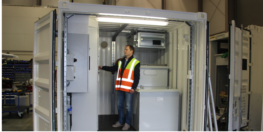
Sverre Knapstad与一台配备10-英尺机箱的崭新450 kVA紧凑型岸基供电装置。VACON®变频器安装了客户需要的控制器和指示灯。
