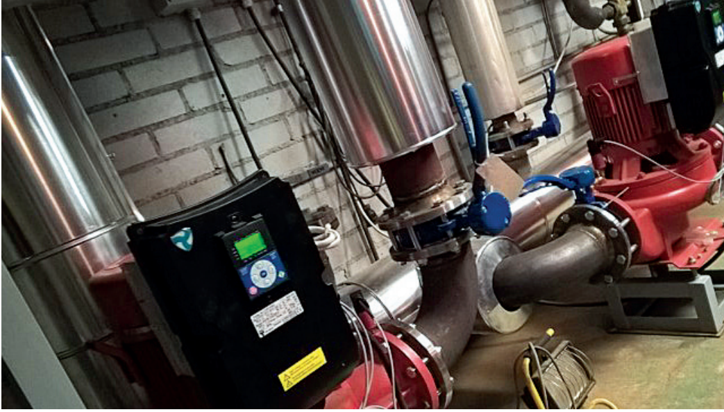
Kolmeks'in 7,5 kW (3 fazlı) motorlu, güncellenen sıralı pompa ailesine VACON® 20 Cold Plate entegre edildi.
