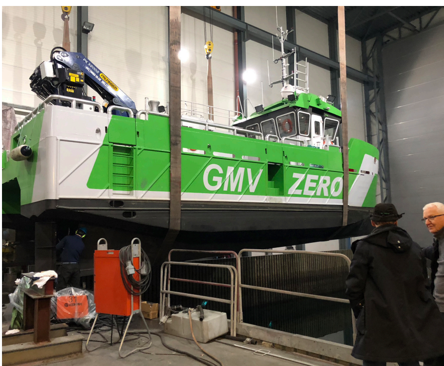
Astrid Helene är en 14 meter lång och 8 meter bred aluminiumarbetsbåt av katamarantyp. Bild från bygandet av båten vid Grovfjord Mekaniske Verksted.
