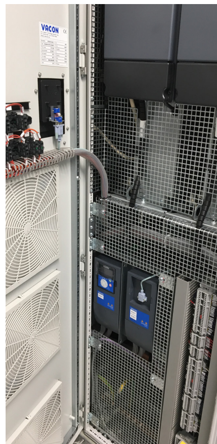
Particolare del quadro VFD che ospita un inverter della famiglia Danfoss Drives VACON® NXP
