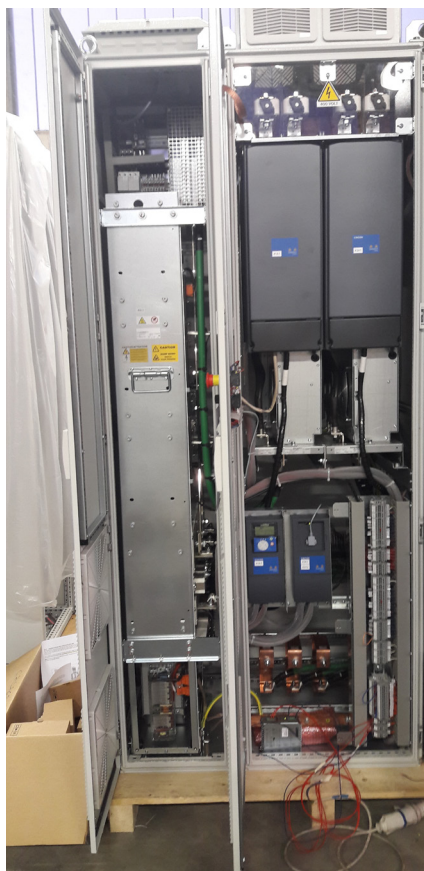
Quadro elettrico destinato al termovalorizzatore di Edimburgo in fase di collaudo finale nella fabbrica di Casagrande Elettrocostruzioni a Verona
