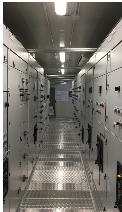
Interno di un container realizzato da Casagrande Elettrocostruzioni destinato all'impianto di termovalorizzazione di Edinburgo
