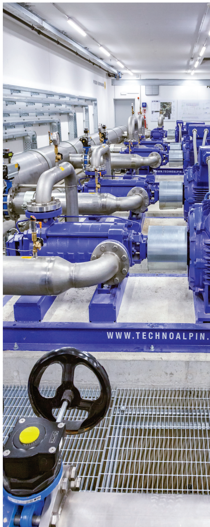
Blick auf die Hauptpumpstation, die sich unterhalb der Anlage befindet.
