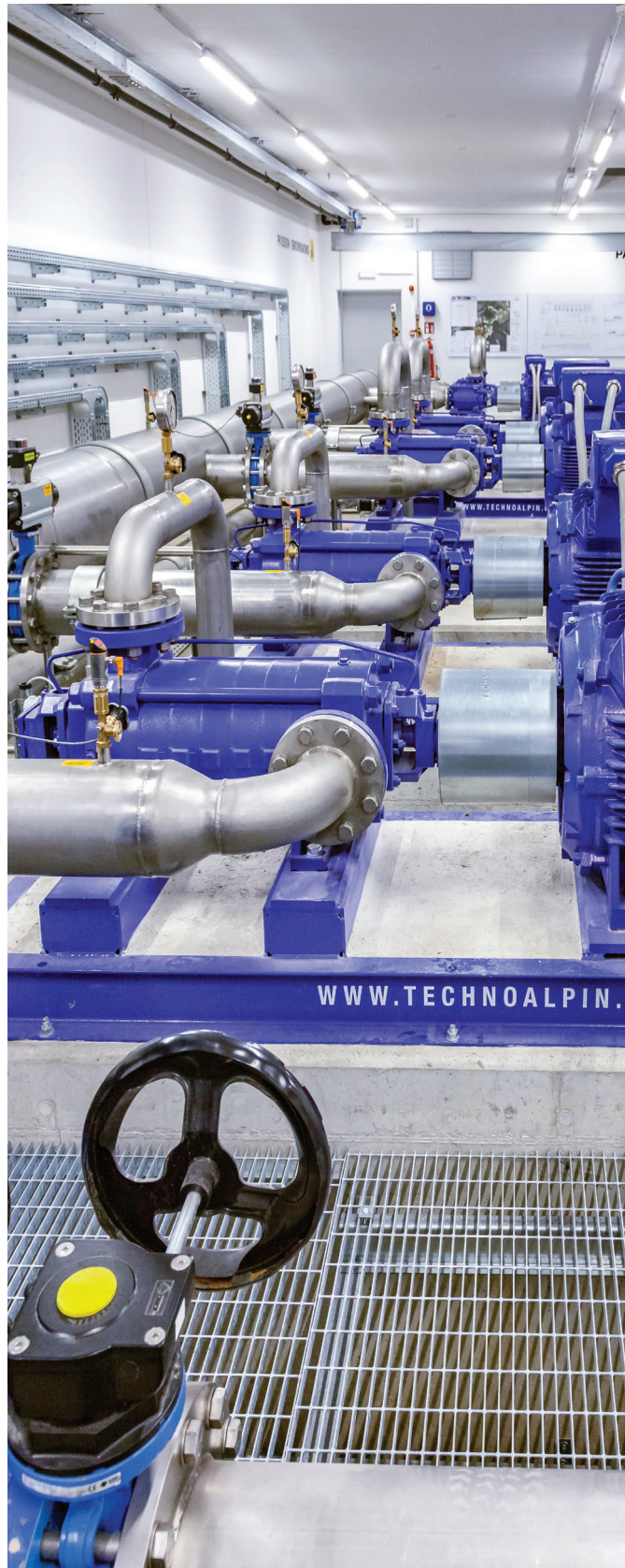
Bild av huvudpumpstationen, nedströms från anläggningen.
