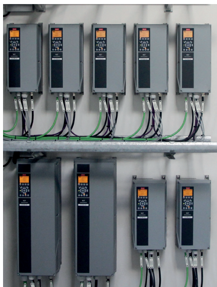
MEC – BioGas har använt täthetsklass IP55 på en del av sina VLT® AutomationDrive FC 302, eftersom denna typ är särskilt lämplig till installation i krävande miljöer.
