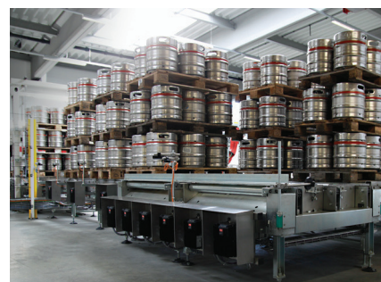
Los motores de transporte de palés de la zona seca están controlados por 40 convertidores de frecuencia descentralizados VLT® FCD 300. Están provistos de tapas para protegerlos de caídas de barriles
