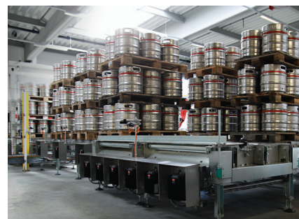
K regulaci elektromotorů pro přepravu palet v suchém úseku je použito 40 jednotek VLT® DecentralDrive FC 300. Jsou opatřeny kryty na ochranu před padajícími sudy.
