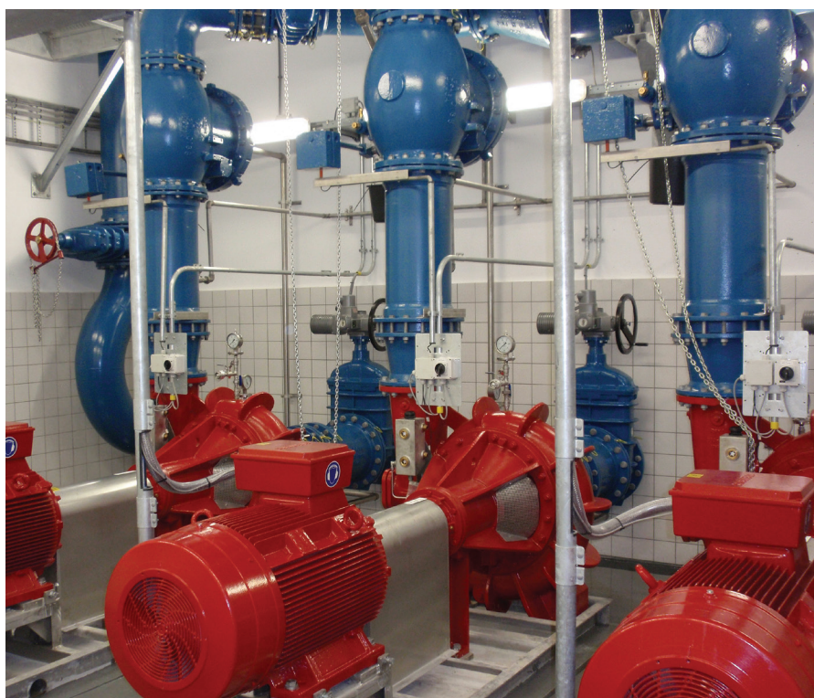
In cascade opgestelde pompen in een rioolgemaal
