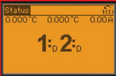
Ablese des Verdichterstatus direkt vom Display. D = Variable Drehzahlregelung, O = Aus, R = Netzbetrieb, X = Deaktiviert
