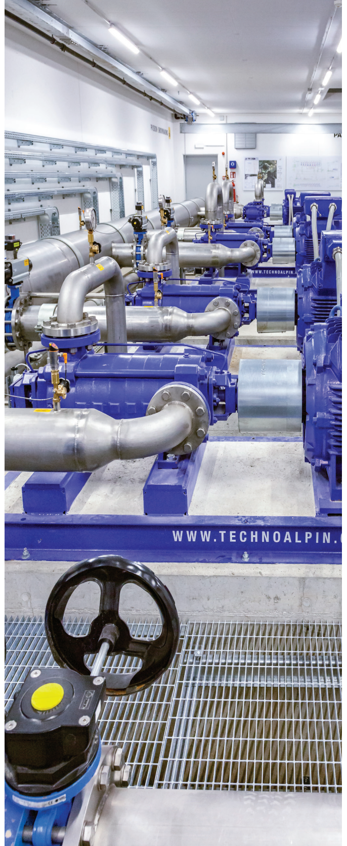
Tesisin aşağı akış yönünde bulunan ana pompalama istasyonunun görünümü.
