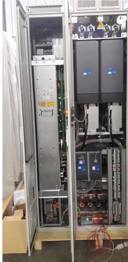
Verona'daki Casagrande Elettrocostruzioni fabrikasında Edinburgh'daki atık tesisi için son testleri yapılan elektrik panosu
