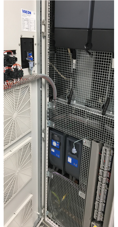
İçinde Danfoss Drives VACON® NXP bulunan Casagrande Elettrocostruzioni elektrik panosundan detay
