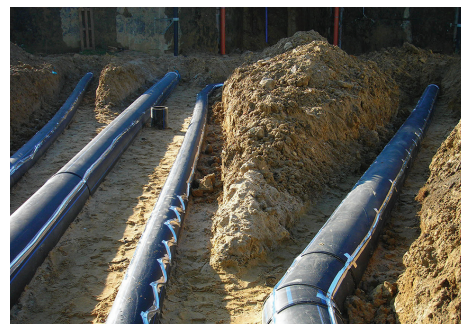
Rørledning i Strzelce Opolskie, Polen
