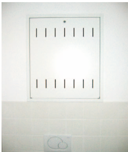
Lakás-hőközpont burkolattal, süllyesztett beépítéssel egy fürdőszobai aknatérben.
