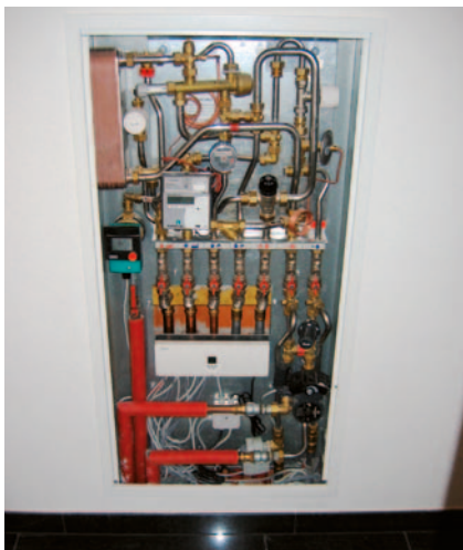
Süllyesztett beépítésű lakás-hőközpont padlófűtés elosztó egységgel és szabályozóval.
