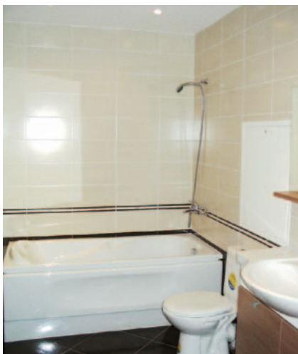
Falmélyedésbe süllyesztett lakás-hőközpont egy fürdőszobában.
