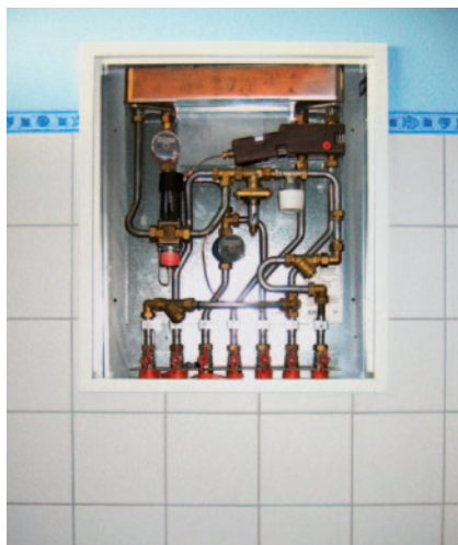
Süllyesztett beépítésű lakás-hőközpont egy fürdőszobában.
