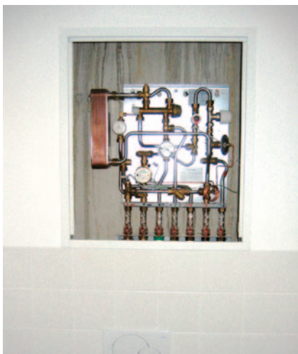
Süllyesztett beépítésű Lakás-hőközpont egy fürdőszobai aknatérben.
