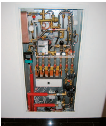
Zabudovaná bytová stanica s rozdeľovačom a regulátorom
