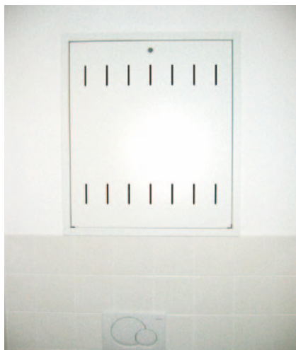
Bytová stanica s krytom, zabudovaná v šachte v kúpeľni
