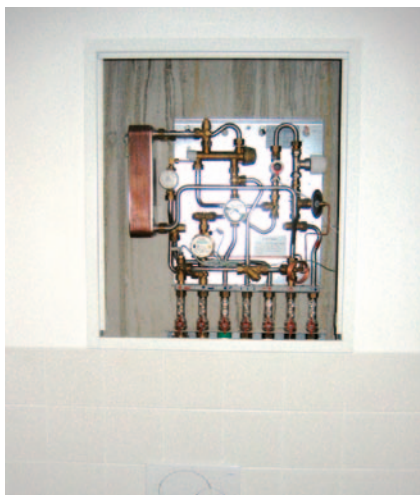
Zabudovaná bytová stanica v šachte v kúpeľni
