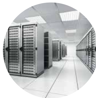
Raffreddamento di server e armadi elettrici
