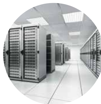
Koeling van servers en elektroniekasten
