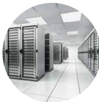
Chłodzenie serwerów i szaf z układami elektronicznymi
