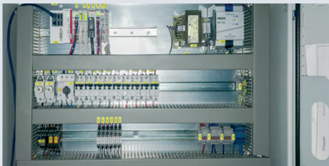
Щит автоматизації орендаря, оптимізований завдяки застосуванню NovoCon
