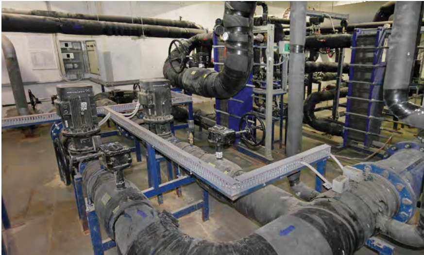
Общий вид ИТП
