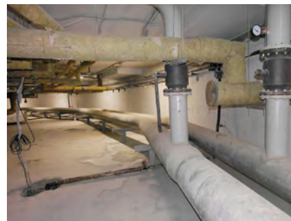
Магистральные трубопроводы контура водяной петли, опоясывающие здание по периметру
