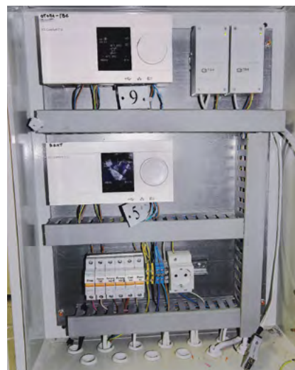
Щит автоматики ИТП
