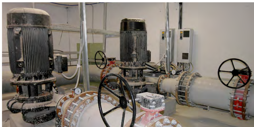
Расход теплоносителя в магистральных трубопроводах контура водяной петли обеспечивают насосы, управляемые преобразователями частоты Danfoss
