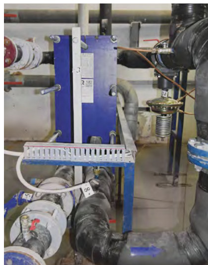
ПТО ГВС в виде двухступенчатого моноблока
