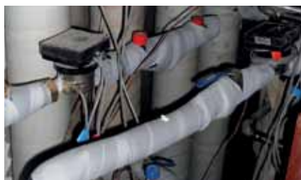
Vyvažovací ventily Danfoss ASV a elektroměry byly instalovány v technické místnosti pro každou skupinu čtyř bytů.
