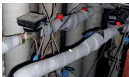
Danfoss ASV:s balanseringsventiler och energimätare installerades i teknikrummet för varje grupp om fyra lägenheter.
