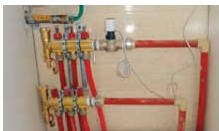
Danfoss-förgreningsrör med RA-G-ventil och TWA-A-ställdon. Den här kombinationen installerades i de mindre lägenheterna för att tillhandahålla central temperaturstyrning via en CWD-termostat i vardagsrummet. Individuella rumsstyrenheter installerades i de större lägenheterna.
