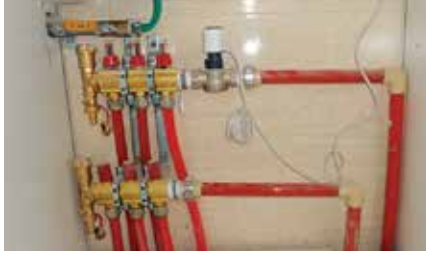
RA-G vanalı ve TWA-A aktüatörlü Danfoss kollektörü. Bu kombinasyon daha küçük dairelerde, salona konulan bir CWD termostatı ile merkezi bir sıcaklık kontrolü sağlamak için kurulmuştur. Bireysel oda kontrolleri daha büyük apartmanlarda kurulmuştur.
