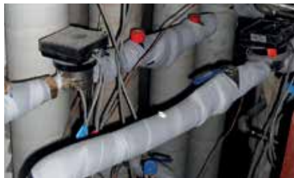
Балансировочные клапаны Danfoss ASV и теплосчетчики установлены в каждом техническом помещении для каждой группы из четырех квартир.
