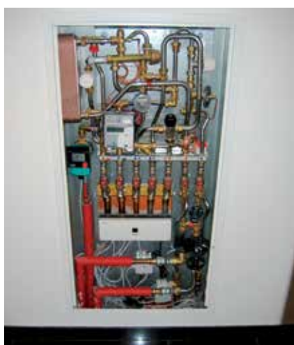
Podometna montaža stanovanjske postaje z distribucijsko enoto za talno ogrevanje in regulatorjem.
