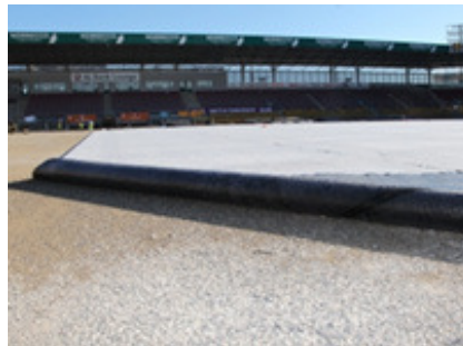
Dräneringsmatta, direkt på marken.
