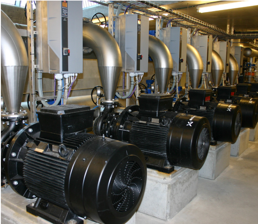
Alle 15 store pumper på vandcentret er forsynet med Danfoss frekvensomformere, type VLT® AQUA Drive FC202 med Profibus.
