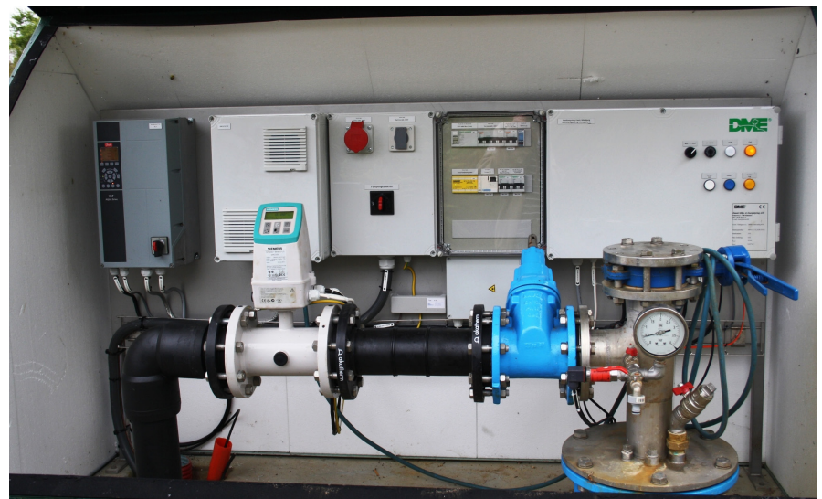
Danfoss frekvensomformere, type VLT® AQUA Drive FC202 med Profibus og indbygget indgangsafbryder monteret ude ved pumpebrønd.
