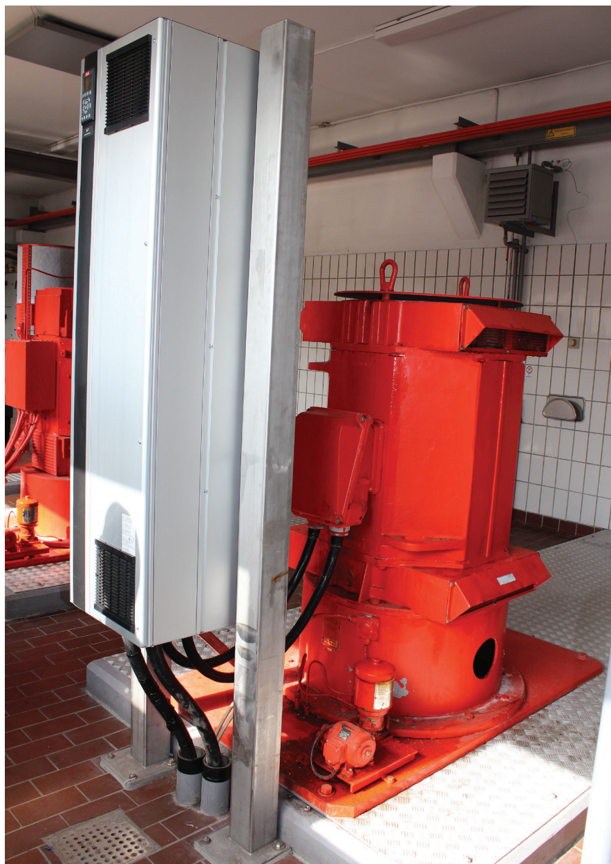
Poste de pompage d'évacuation : Un VLT® de puissance nominale de 160 kW avec boîtier IP54 commande cette pompe pesant 1,25 tonne
