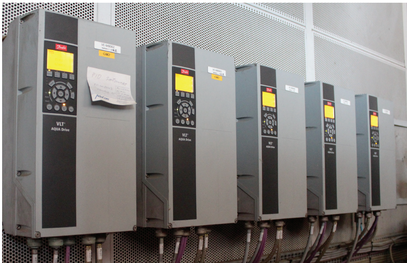
Production d'électricité grâce aux biogaz : les variateurs VLT® AQUA Drives commandent les ventilateurs de refroidissement et l'installation de surpression.
