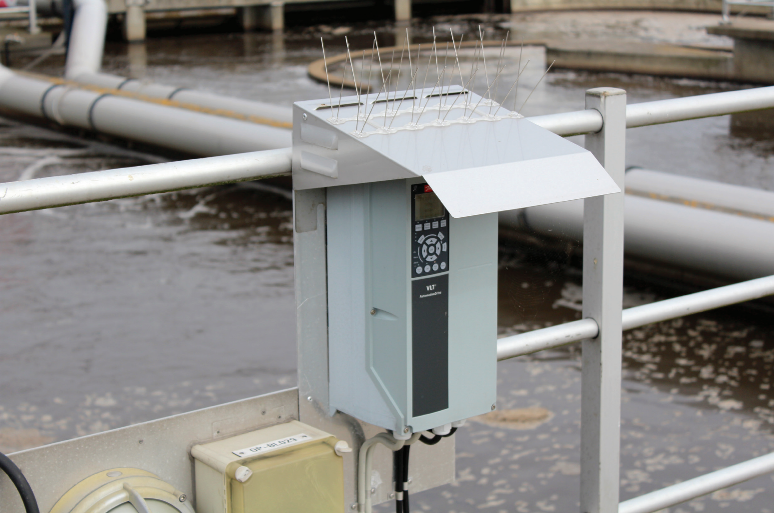
Nitrification & dénitrification avancées des boues : 16 variateurs VLT® de puissance nominale de 4 kW avec PROFIBUS, filtre RFI, niveau de protection IP 66 et casquette de protection, commandent les mélangeurs d'aération.
