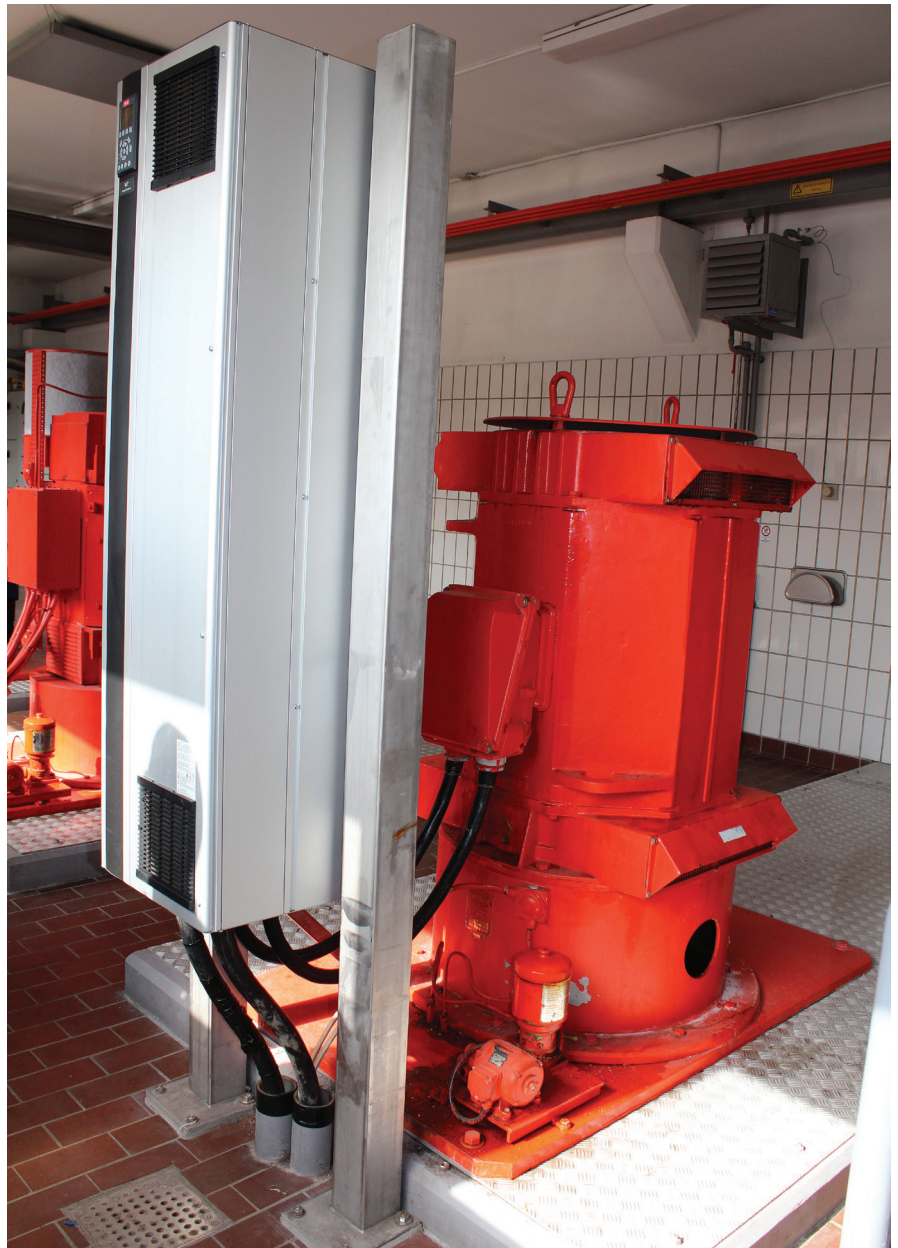
Afvoerpompinstallatie: een VLT® van 160 kW in IP 54 uitvoering bestuurt deze pomp van 1,25 ton
