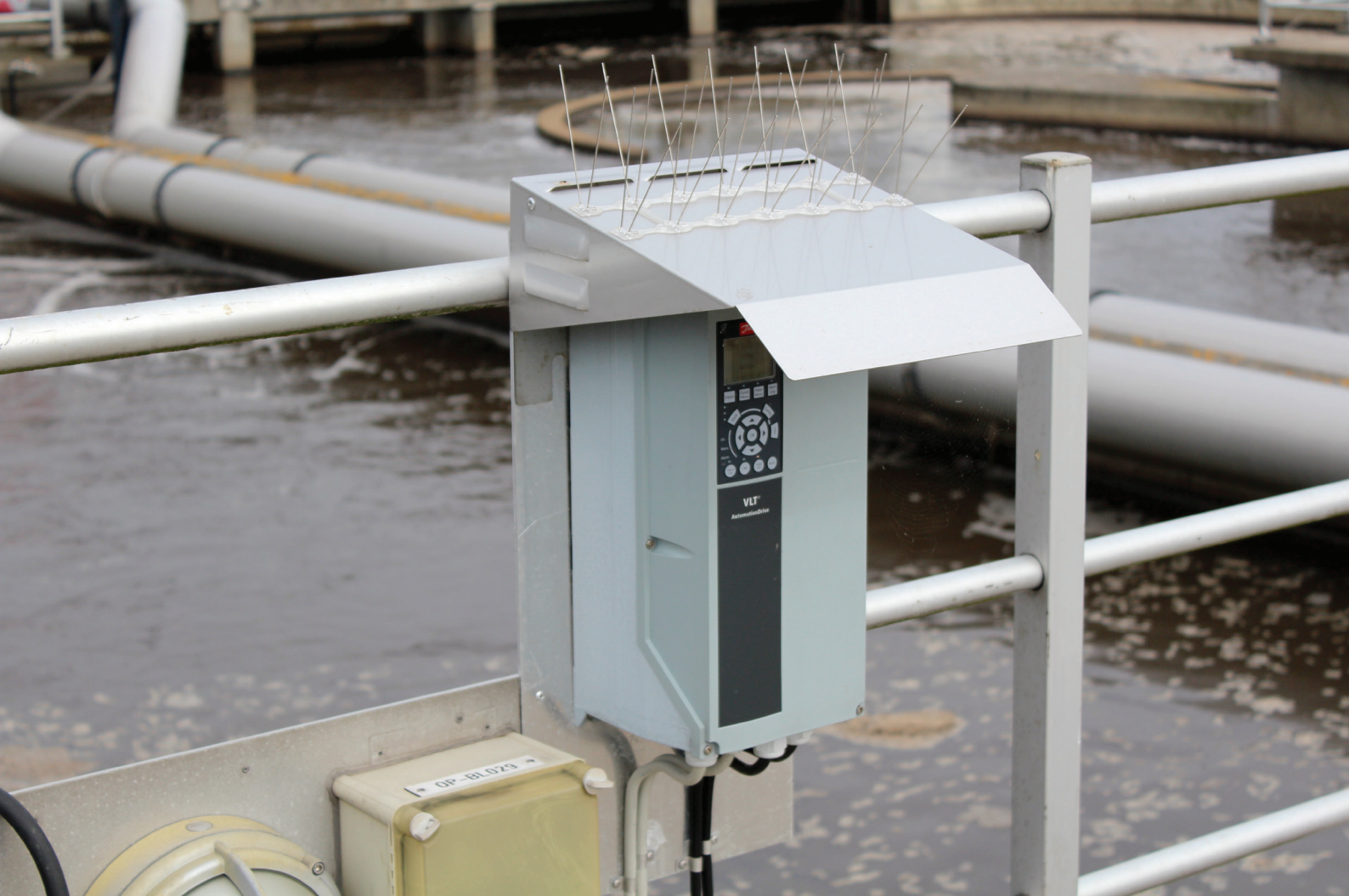
Actieve nitrificatie en denitrificatie van slib: 16 VLT® Drives van 4 kW met PROFIBUS, RFI-filter, IP 66-uitvoering en klimaatbescherming, regelen de luchtmengers.
