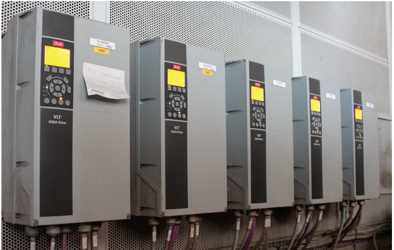
Stroomopwekking met biogas: VLT® AQUA Drives regelen de koelventilatoren en de boosterinstallatie
