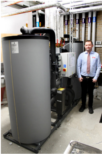
Morten ja lämmöntalteenottoyksikkö.
