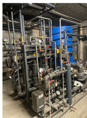
Sous-stations du réseau
