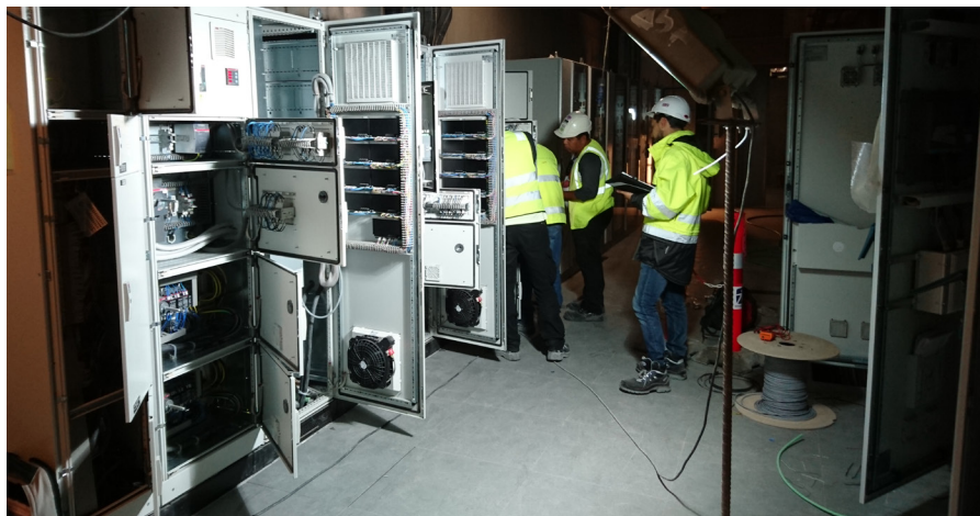
Quadri della stazione denominata “FBA” già piazzati al piano tecnico e fotografati durante i collaudi eseguiti congiuntamente da Systemair e H.S. Progetti.
