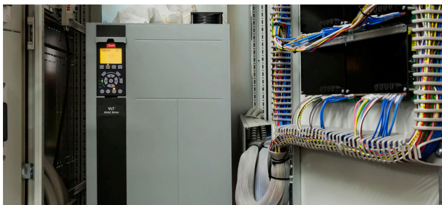
Danfoss Drives VLT® HVAC Drive FC102 250 kW montato all'interno del suo cubicolo
