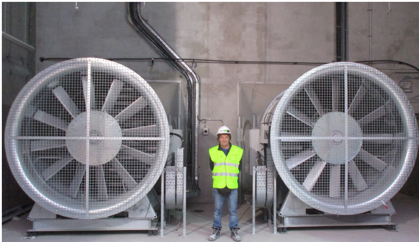
N.2 ventilatori assiali reversibili modello AXR 2000-12, certificati per funzionamento in caso d'incendio a 250°C per 2 ore, e dotati di motori elettrici trifase da 250kW.
