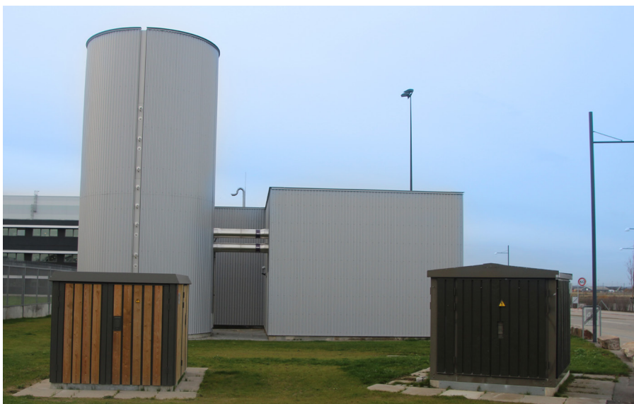
FlexHeat-anlægget oplagrer termisk energi svarende til et "virtuelt batteri" på 4 MWh i lagertanken på 100 m 3 i venstre side af billedet.
