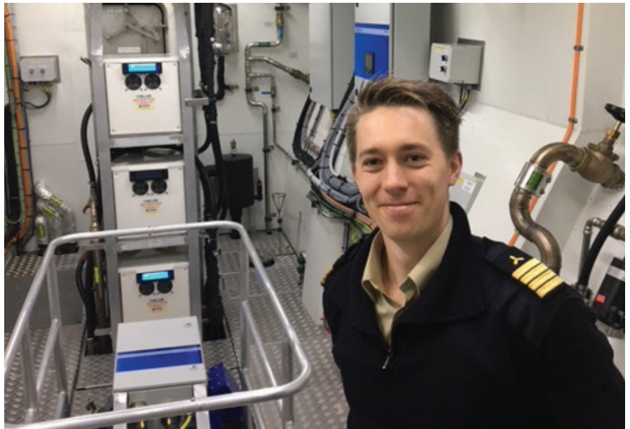
Lars Haugnes is bijzonder tevreden over de prestaties van de Danfoss frequentieregelaars en instrumentatie die in de machinekamer van Future of the Fjords zijn geïnstalleerd en in hoge mate bijdragen aan het beschermen van de ongerepte omgeving van de fjord.
