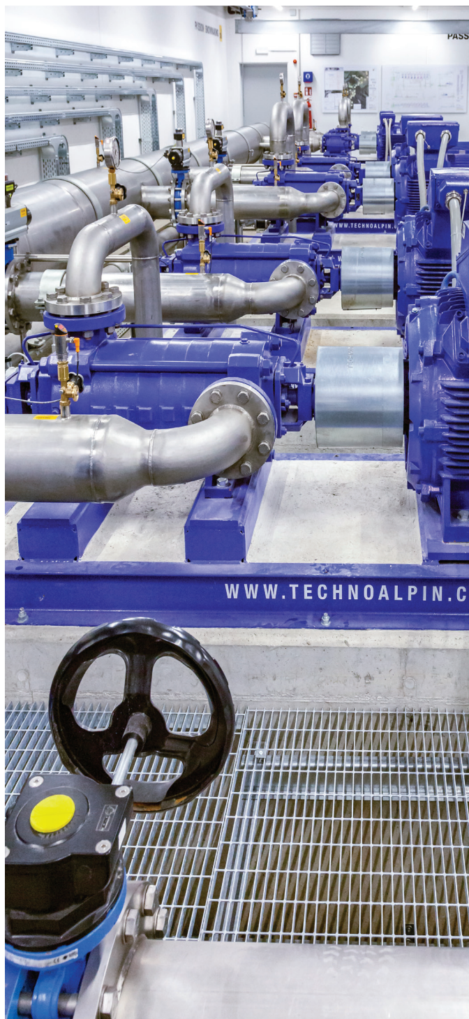
Vista della stazione di pompaggio principale posta a valle dell'impianto.
