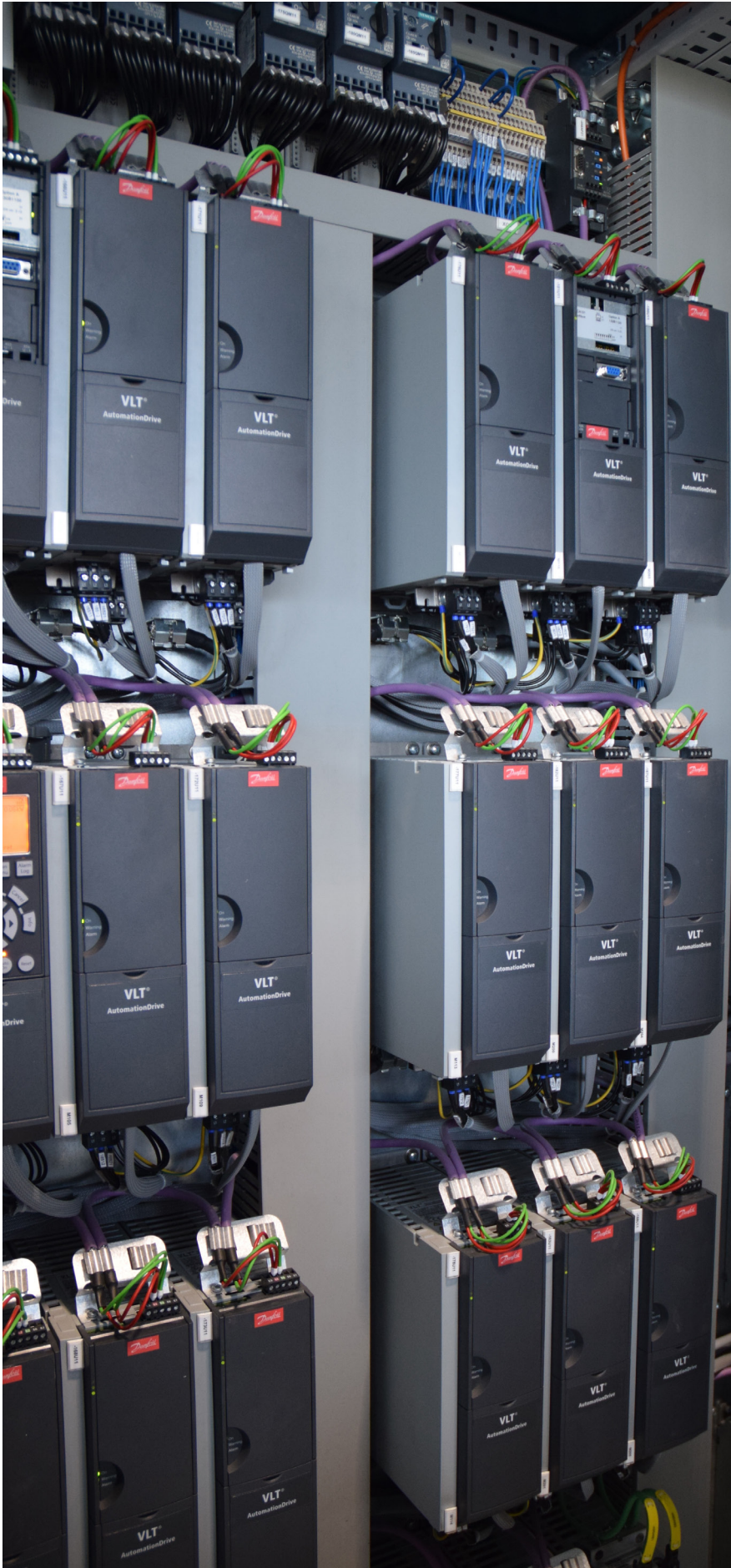
Inverter Danfoss VLT® AutomationDrive FC 302 di taglie appropriate all'esigenza del tipo di trasportatore installati nell'armadio, progettati per il controllo a velocità variabile di tutti i motori sincroni a riluttanza, magneti permanenti e motori asincroni, pensati per aumentare la flessibilità e ottimizzare il controllo dei processi su qualsiasi macchina industriale o linea di produzione.
